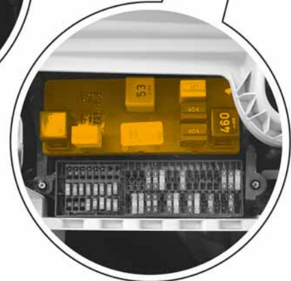
Porte-relais sur le calculateur de réseau de bord, à gauche sous le tableau de bord
